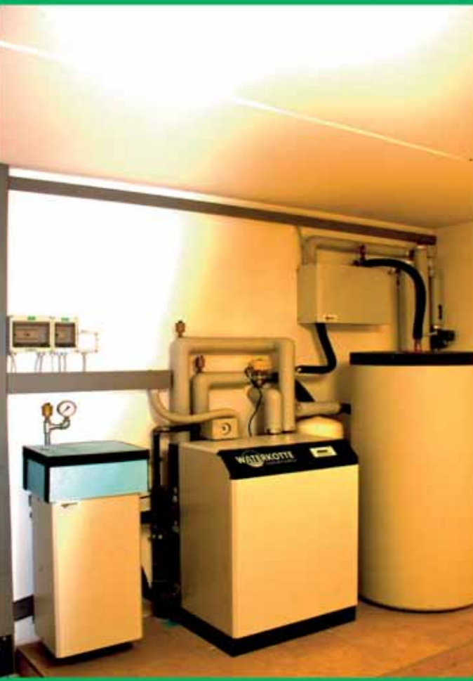
Aufbau der Anlage im Keller eines Hauses
